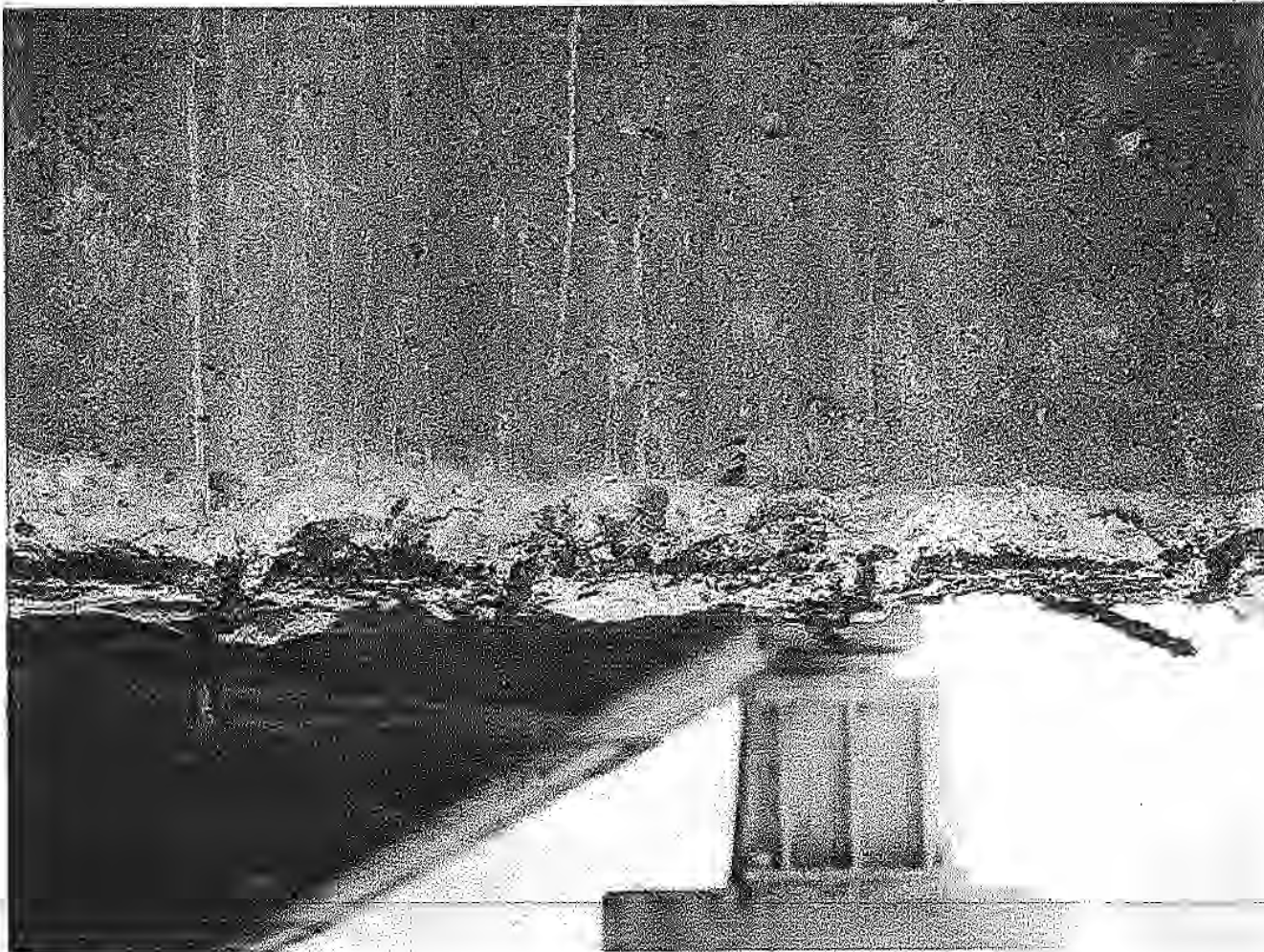
Pier 1A deterioration
