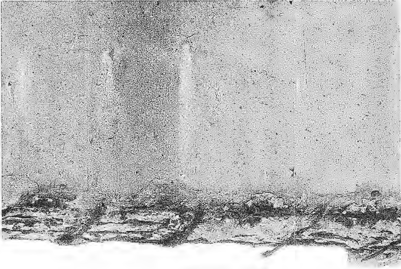
Pier 1A deterioration
